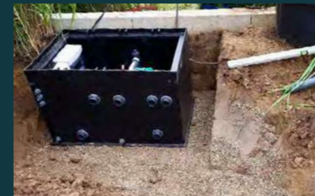
TECHNIKSCHACHT Alles in einem Paket: Von der Filterpumpe bis zum Elektro-Heizer
